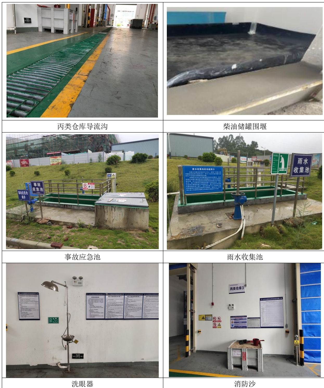
图 4.2-1 项目应急设施照片
