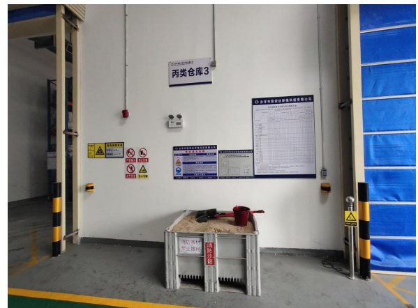
丙类仓库消防设施
